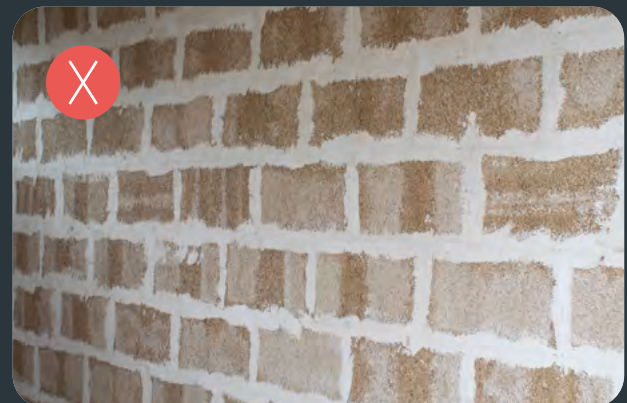
Mala ejecución de juntas
